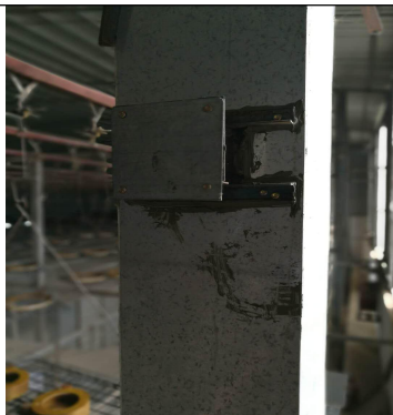
排气筒采样口
