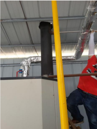
锅炉废气监测
