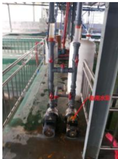
污水处理备用水泵
