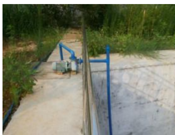
初期雨水收集池回水泵
