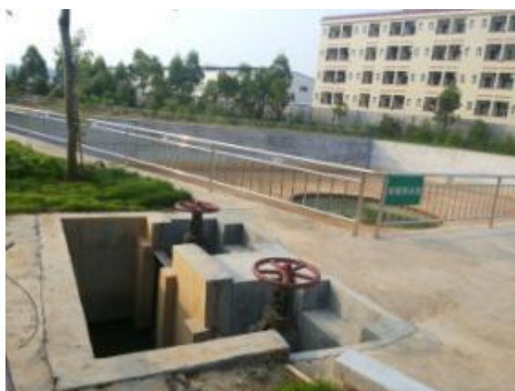
初期雨水收集池及切断水阀
