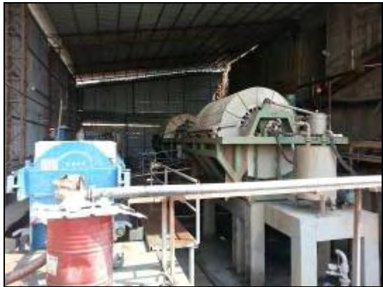
二选厂陶瓷压滤机压滤和箱式压滤机
