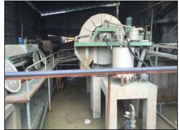
项目二选厂已配套尾砂压滤设备
