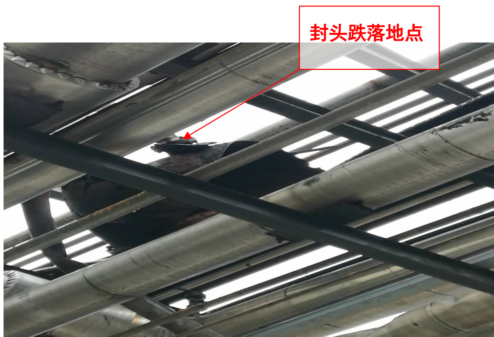
图 5 塔顶封头被炸飞到管廊上面
