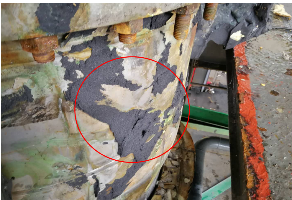
图 7 氯化氢塔塔身变形（第七层）
