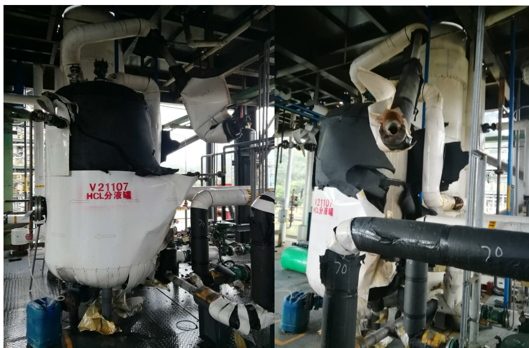
图 13 V21107 氯化氢分液罐的气相管上的衬氟阀门炸开
