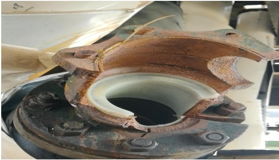
图 14 管线上法兰薄弱处断裂
