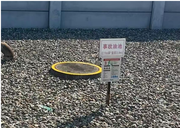
地埋式事故油池
