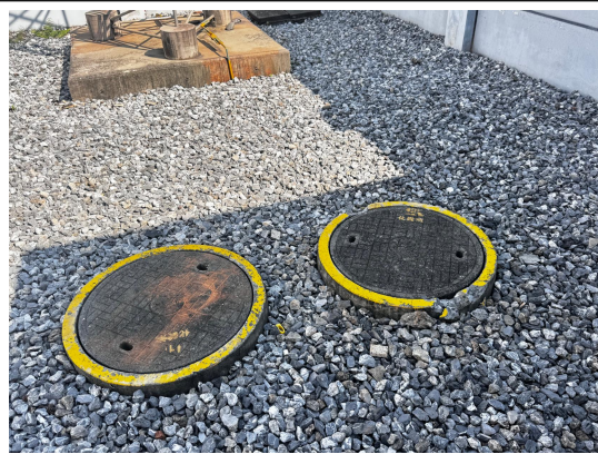
地埋式化粪池
