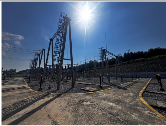
110kV 配电装置区
