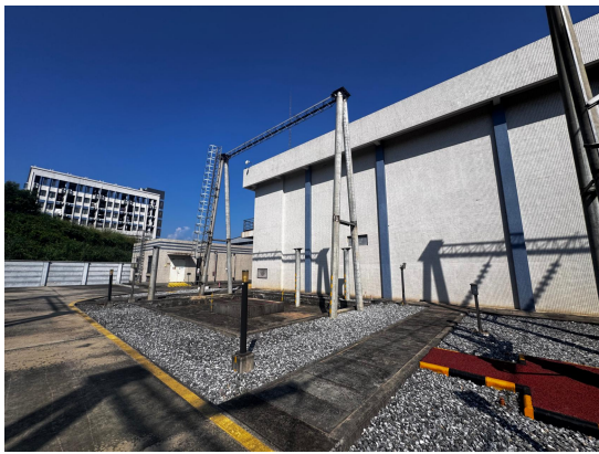
预留#3 主变场地
