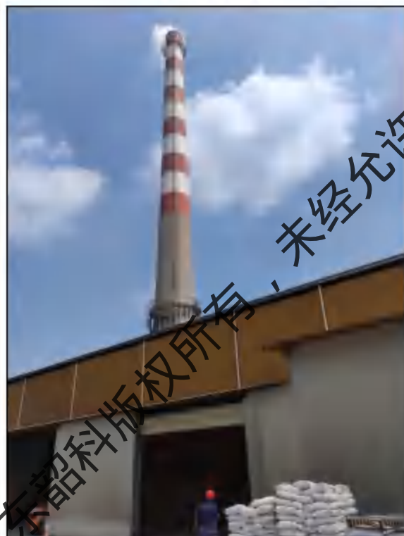
锅炉房废气排气筒
