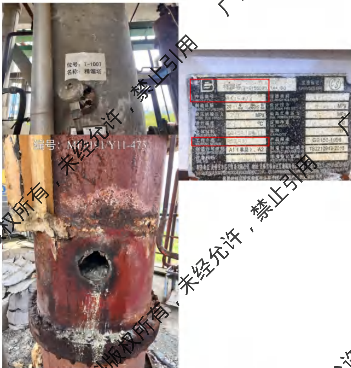
图 2.9-2 江苏中润现场 R32 装置精馏塔
