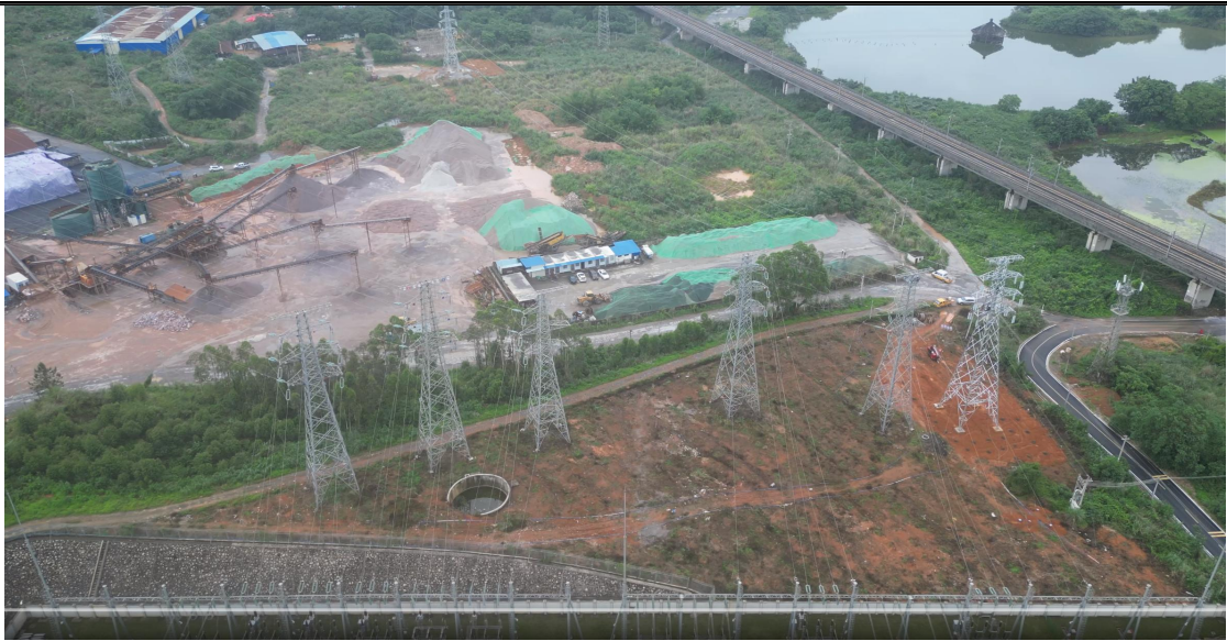
坦界变电站东北侧
