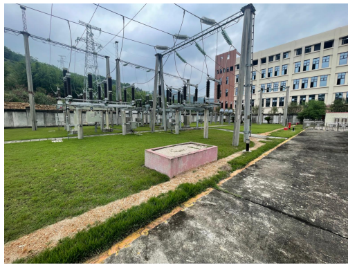
110kV 配电装置区
