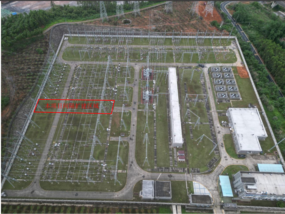
本项目间隔扩建区域
