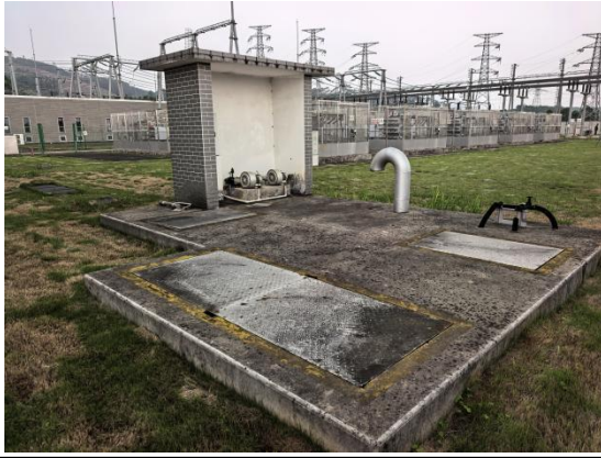
生活污水处理设施
