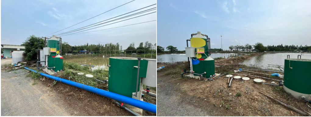
图 3-2-3 “池塘岸基一体化设备”现场图
