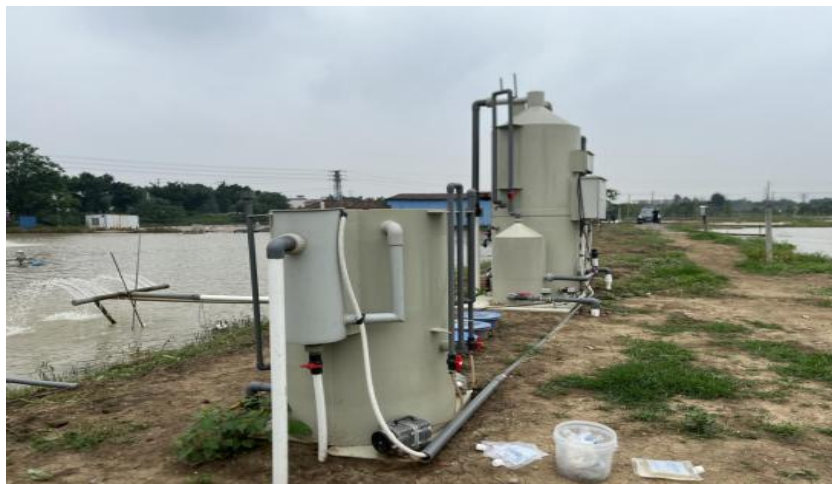
图 3-2-2 “岸基池塘一体化设备”实景图
