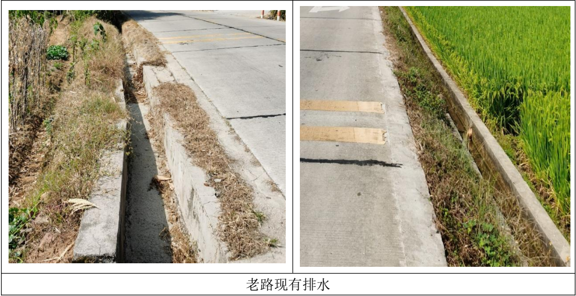
图 3.1-4 老路现有排水及防护的现状图
