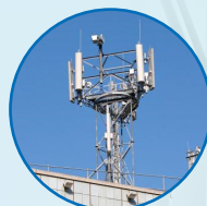
公众移动通信基站
