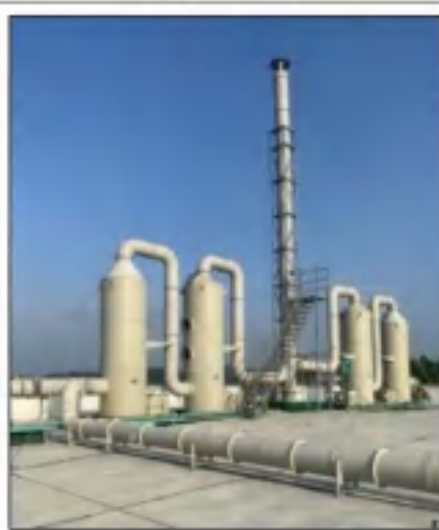
废水处理车间废气处理设施
