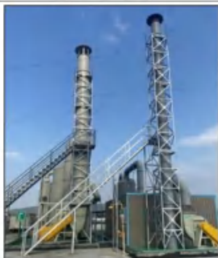
物化车间废气处理设施
