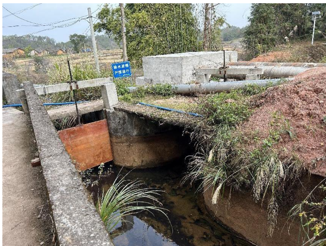
中干渠、东干渠进口节制闸
