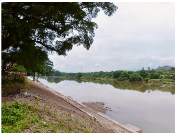
护岸段坡面现状
