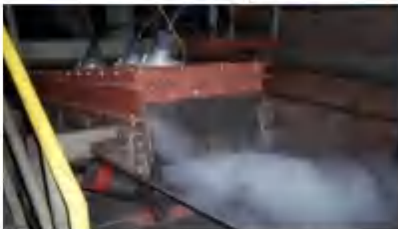
图 7.1-2 转运站内干雾抑尘设施现场照片
