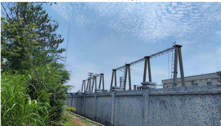
35kV 乌迳站现状
