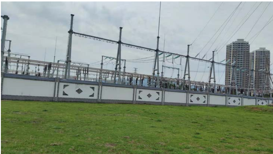
220kV 珠玑站现状
