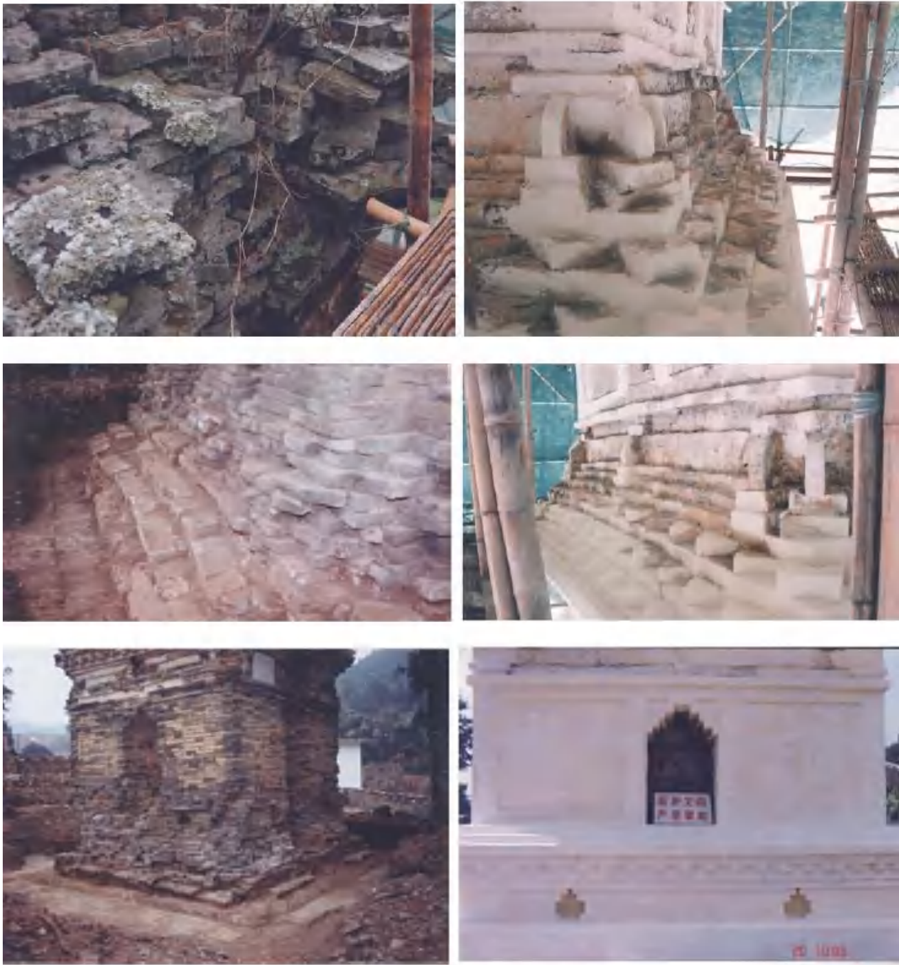
图 8 渐溪寺塔维修前后对比图 2
