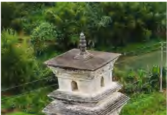
塔刹顶部批荡干裂，檐口泛黑。
