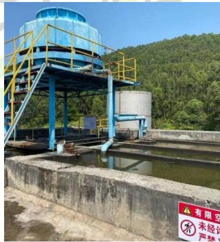
锌合金车间冷却循环池（锌合金环保楼顶）
