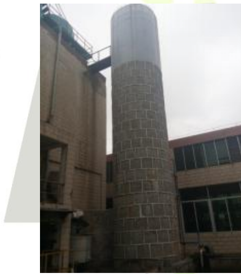
锌合金车间麻石旋流喷淋塔
