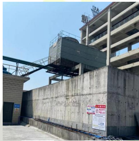
铝合金车间冷却循环池
