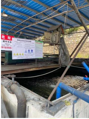
铝合金车间喷淋循环池
