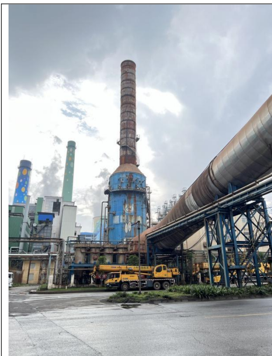
五烧脱硫吸收塔（高硫）
