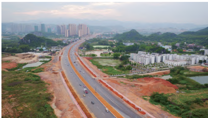
2017年5月10日，韶关市武江区百旺路改扩建工程主体工程完工（韶关日报社 供）
