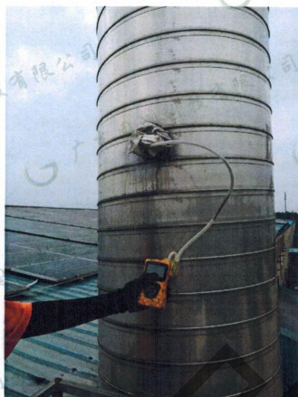
PA 车间工艺废气排放口
