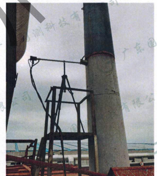
锅炉废气排放口
