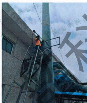
皮革车间前段工艺废气排放口
