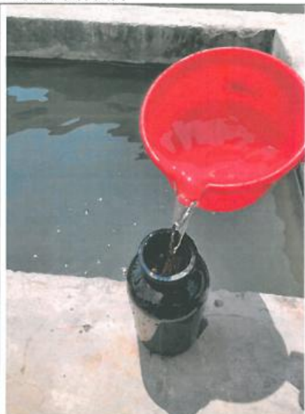
图 9.1 清洗废水处理后排出口 ★W1
